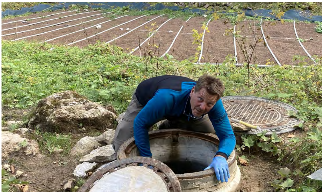
Der neue Wasser- referent Hansjörg Raber am sanierten Schwallschacht. Im Hintergrund das große Filterbeet mit Verteil- rohren. Foto: K. Kürzinger
